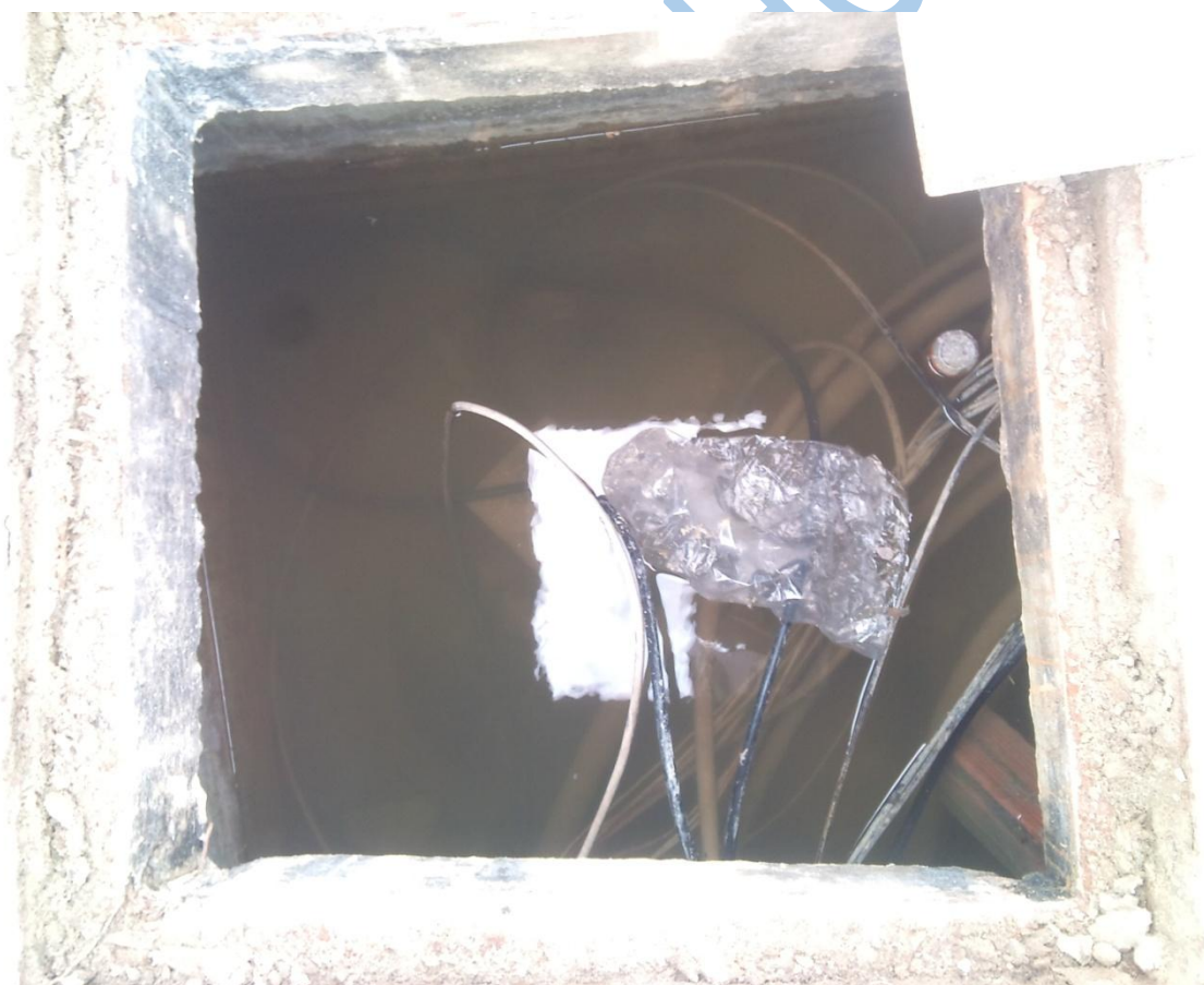
Figure 3 : regard de terre électrique regard N°1 pollution et câbles émerger dans l'eau
