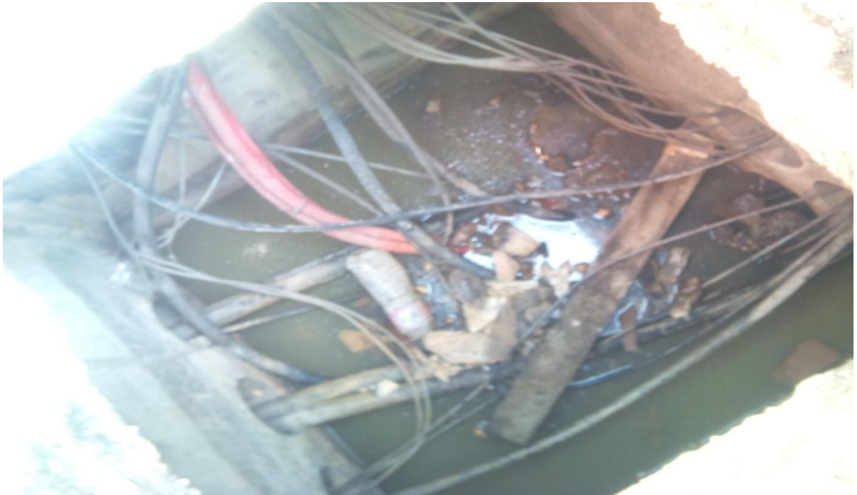
Figure 6:regard de terres électrique N°4
