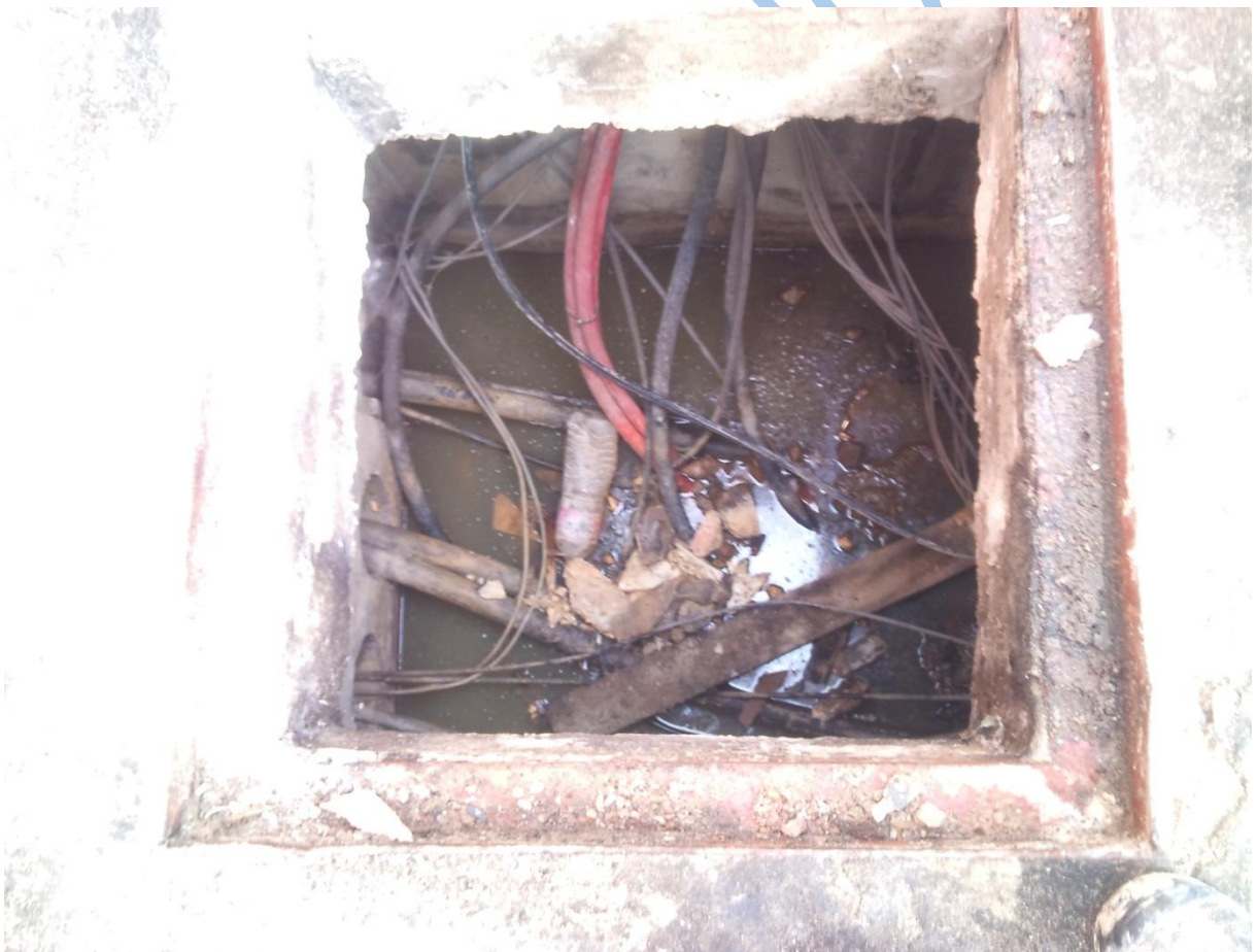
Figure 7:regard de terres électrique N°5
