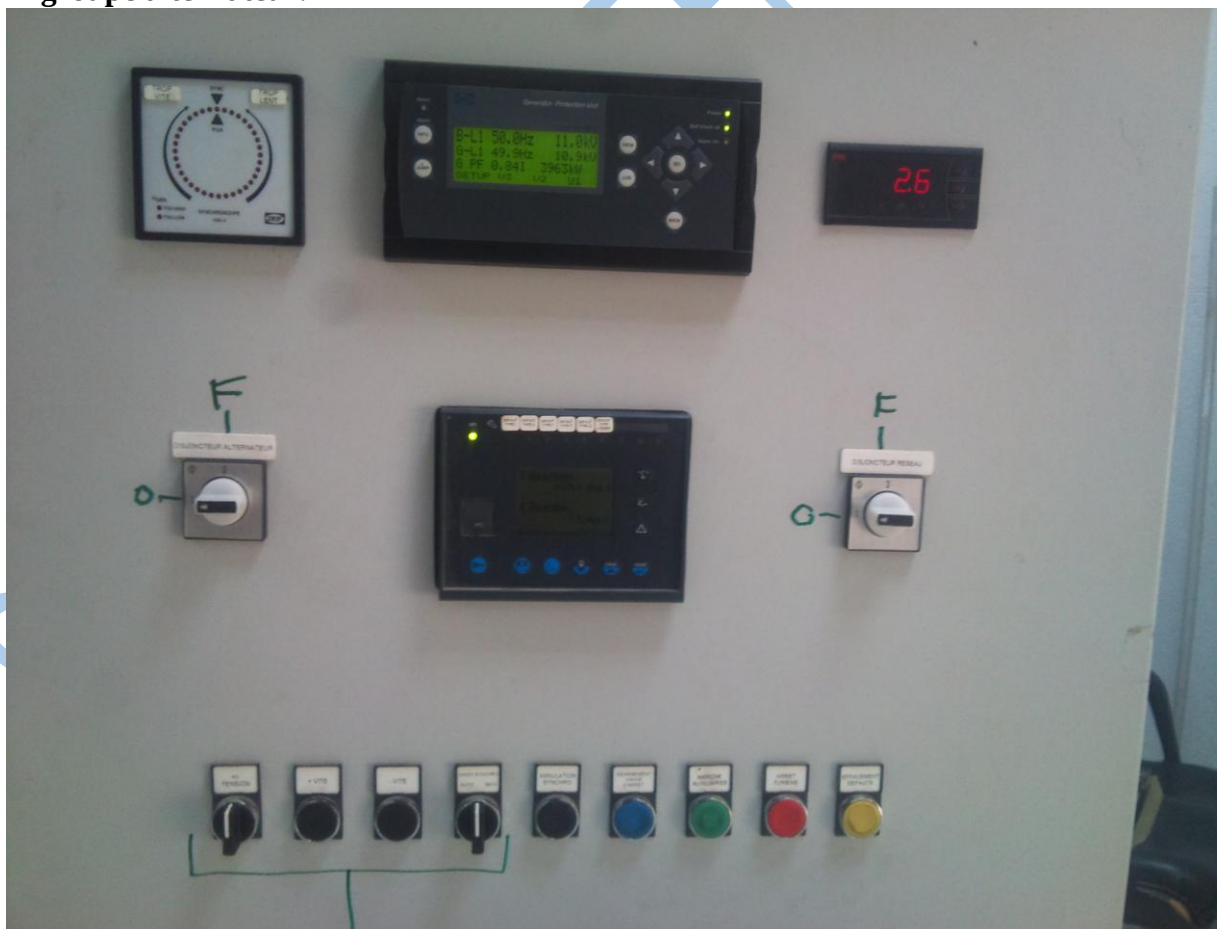
Figure 13 : tableau de commande générale
