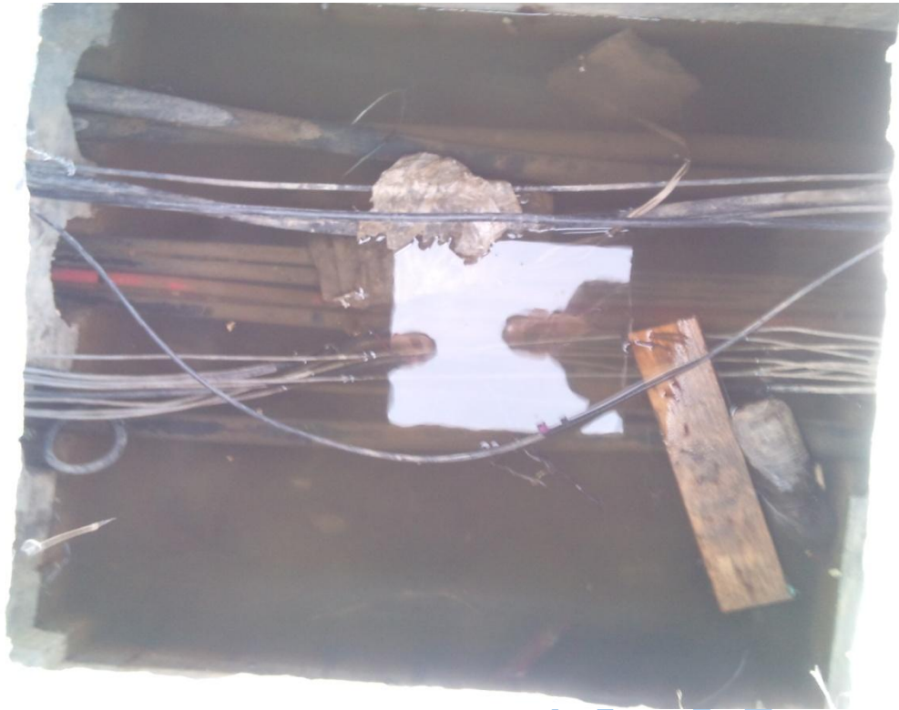
Figure 4:regard de terre électrique regard N°2 pollution et câbles émerger dans l'eau
