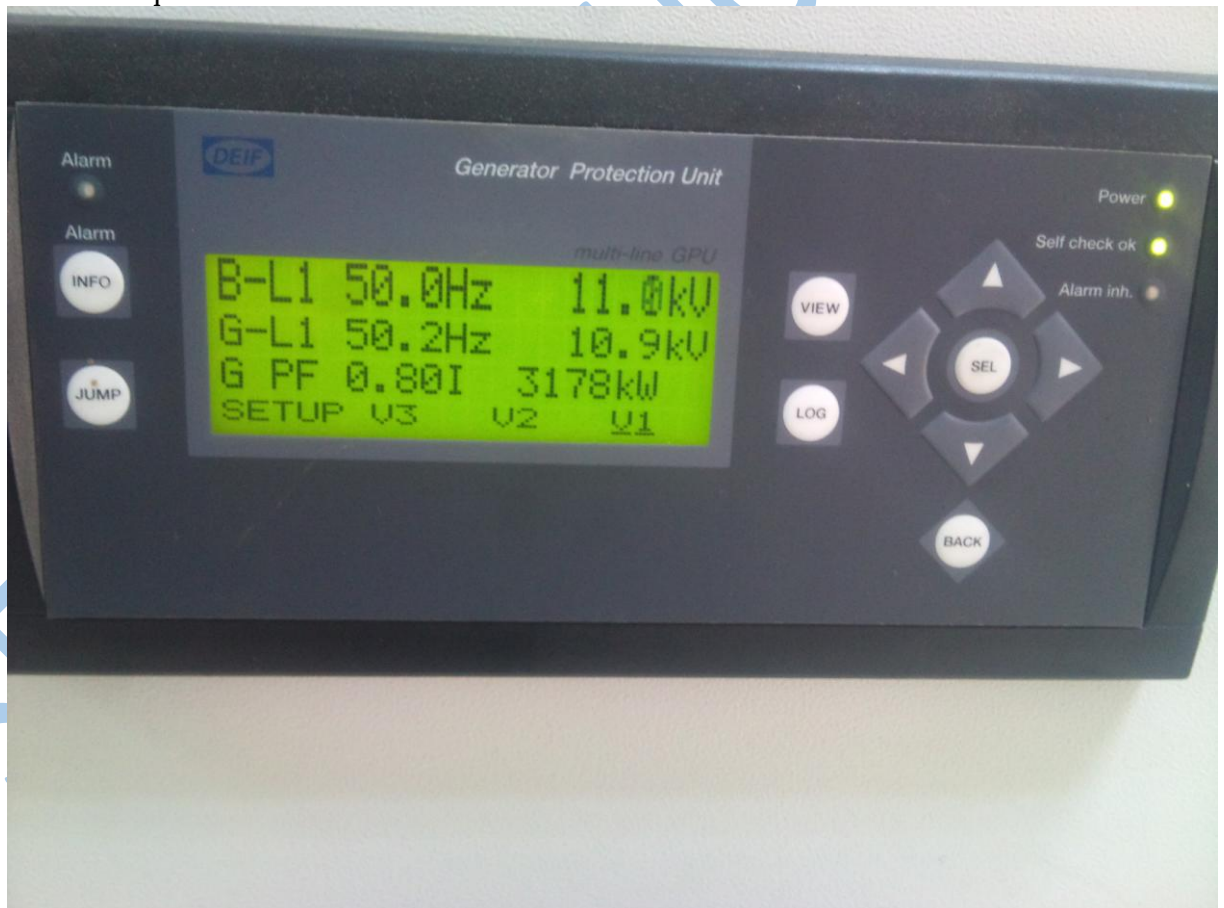
Figure 11: unité de protection du générateur
