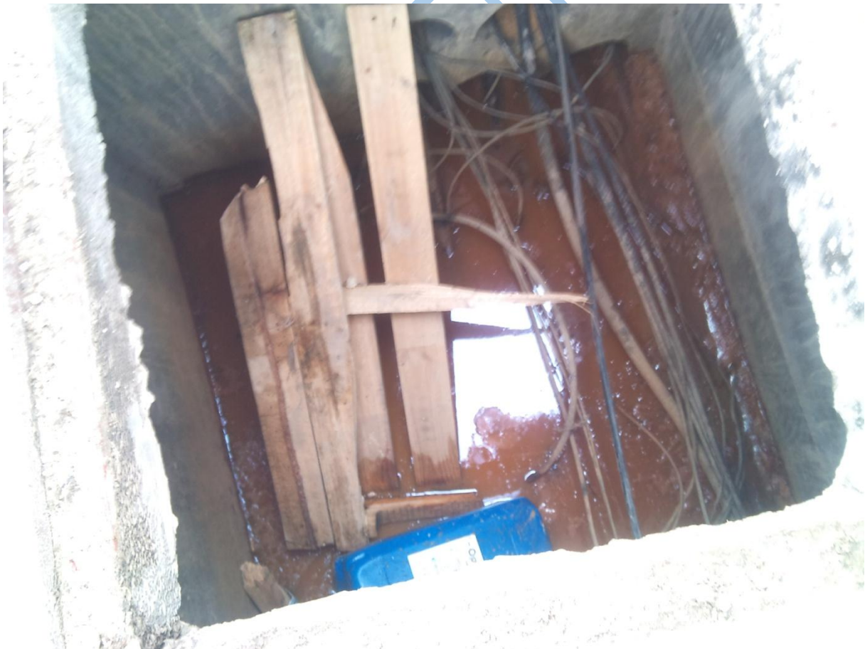
Figure 5:regard de terres électrique N°3
