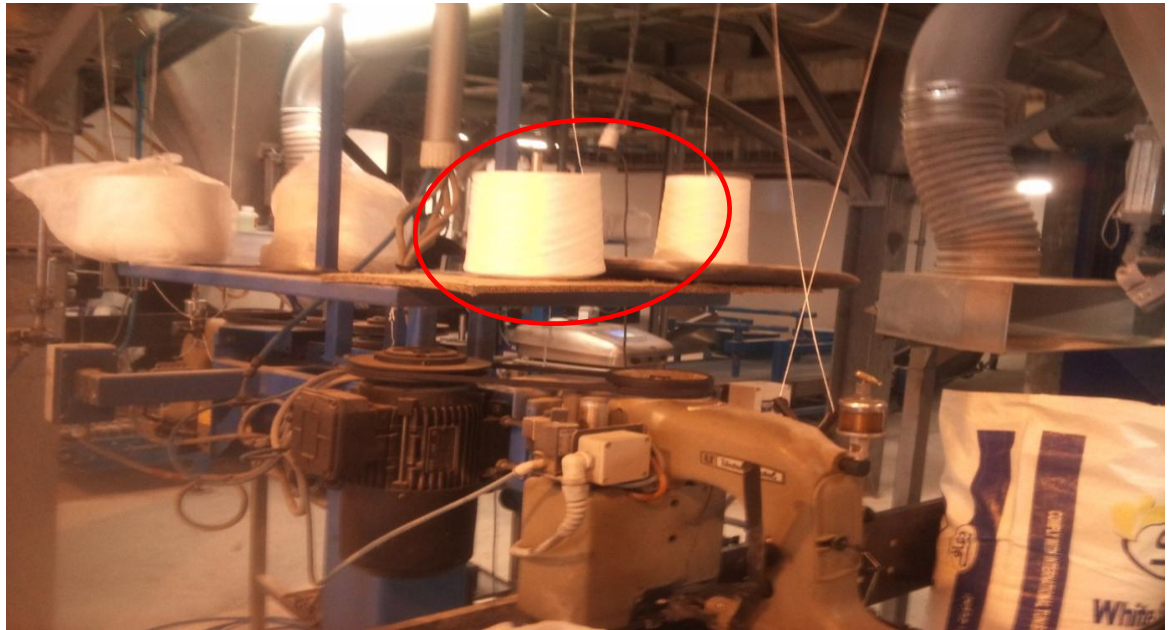
Figure 22 : bobine en mauvais état
