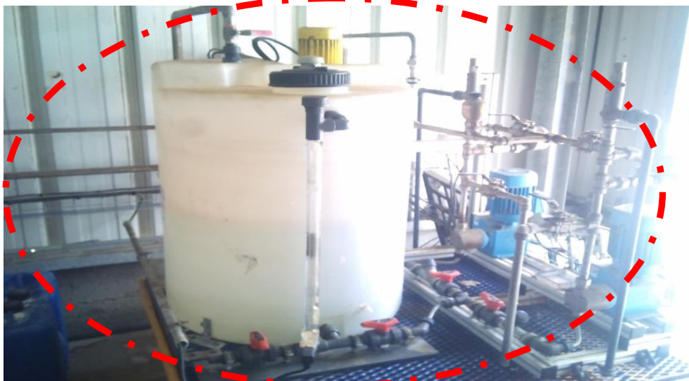
Figure 27 : nettoyage cuve produit chimique "BOILEP"
