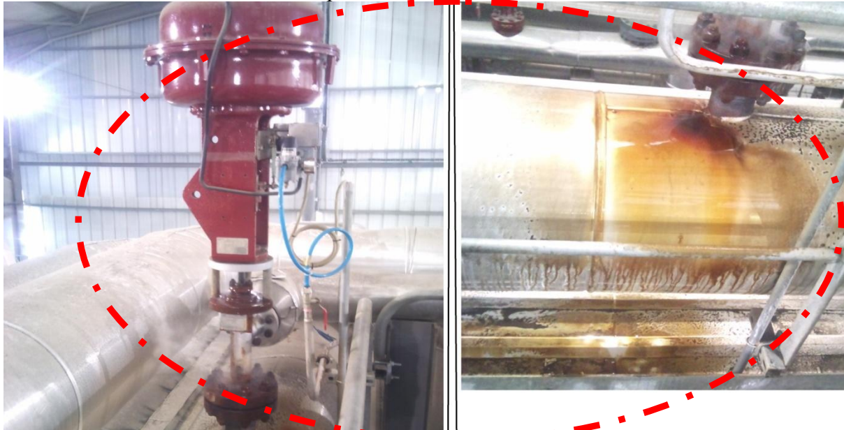
Figure 35: élimination vanne de désurchauffe
