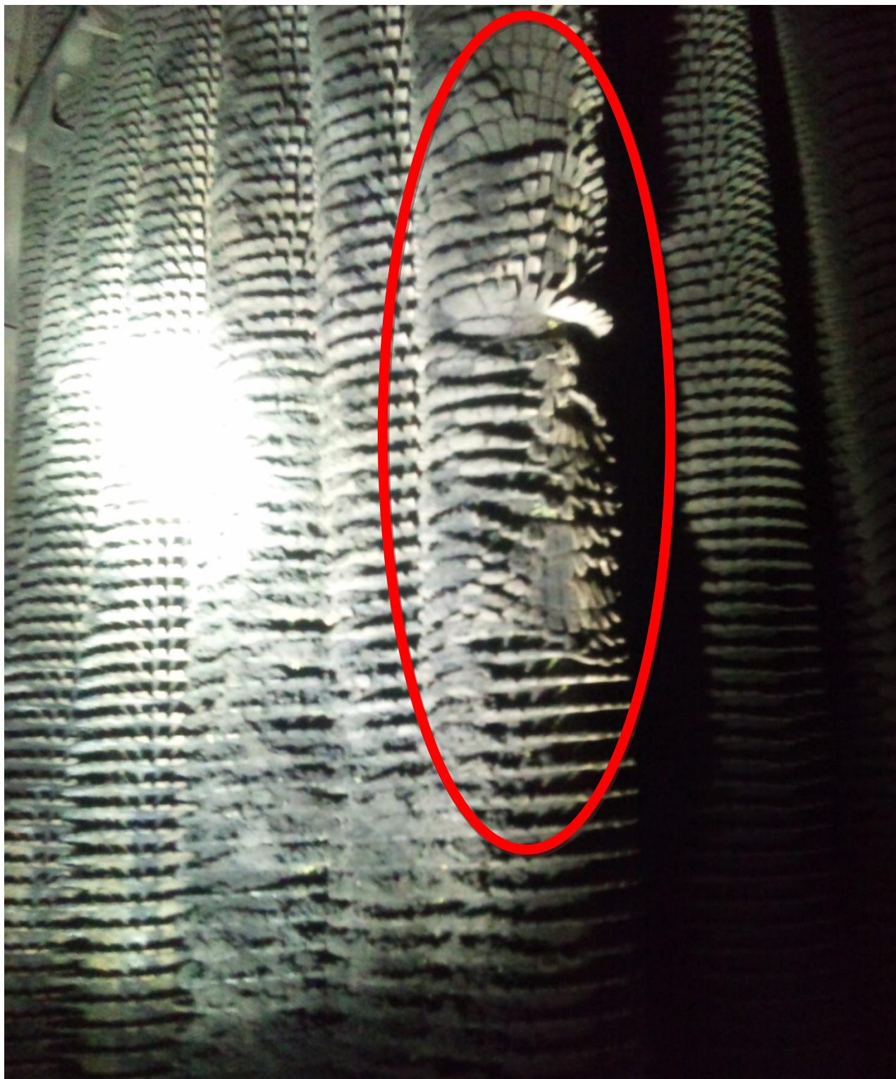
Figure 41 : état a l'intérieur 'colonne ECO'
