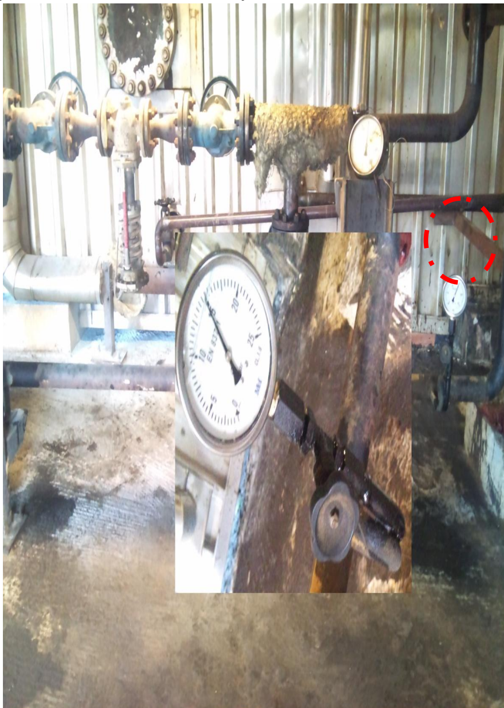
Figure 4 : Manomètre vanne de régulation réchauffage fuel à changer
