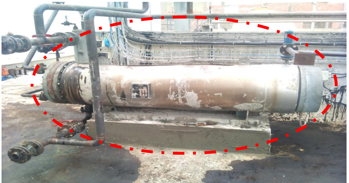
Figure 31 : nouvelle emplacement du réchauffeur fuel ainsi que ses conduites + vannes
