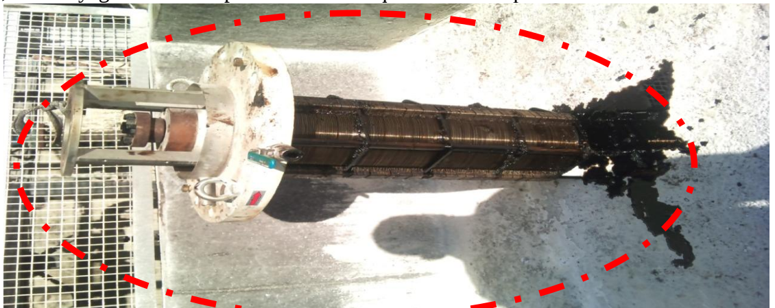
Figure 32 : nettoyages du filtre rotatif à l'intérieures
