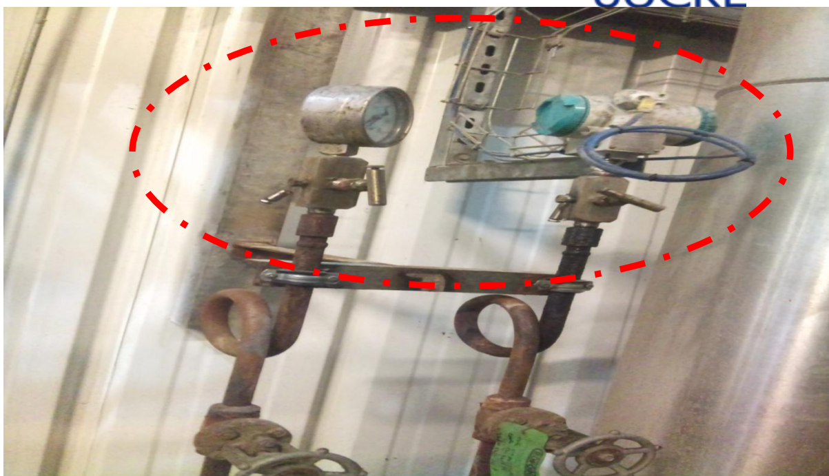
Figure 21 : élimination des fuites de manomètres pour "ramoneurs"
