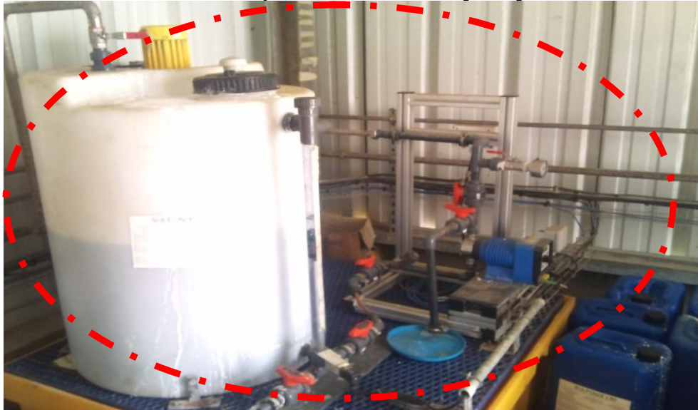
Figure 26 : nettoyage cuve produit chimique (SULFINIXE)
