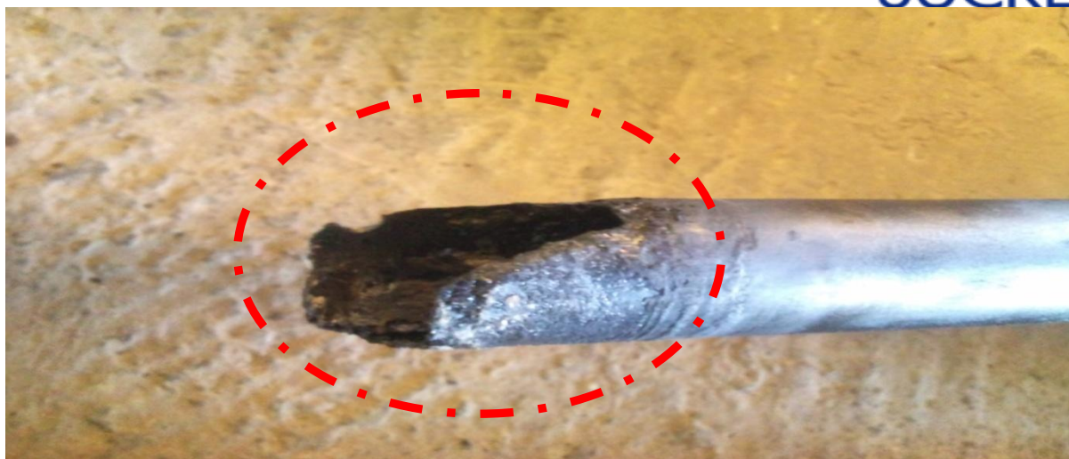
Figure 16 : état de la canne a gaz
