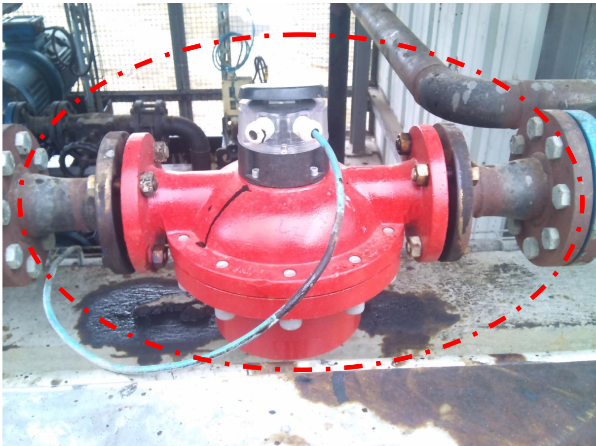
Figure 38 : montage vanne automatique "retour&bac1160.1"
